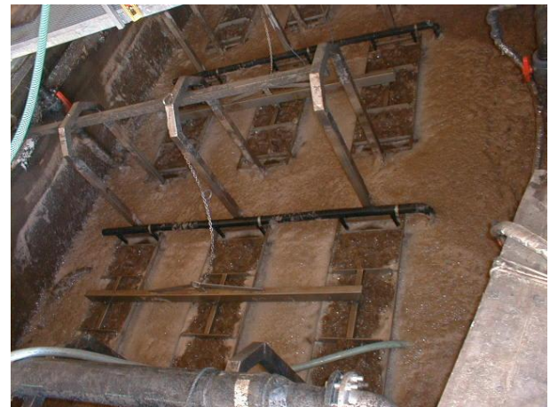
Abbildung 1: Module tauchen in das Membranbelebungsbecken ein
