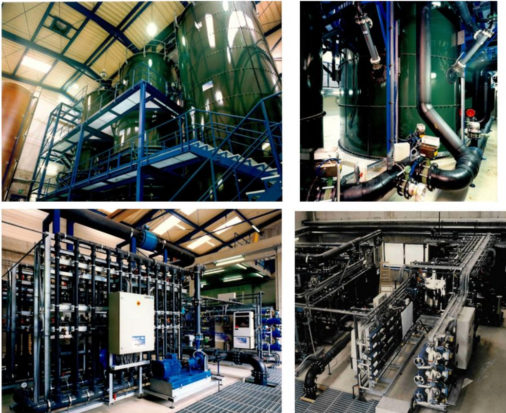
Abbildung 1: Großanlage zur Deponiesickerwasseraufbereitung
